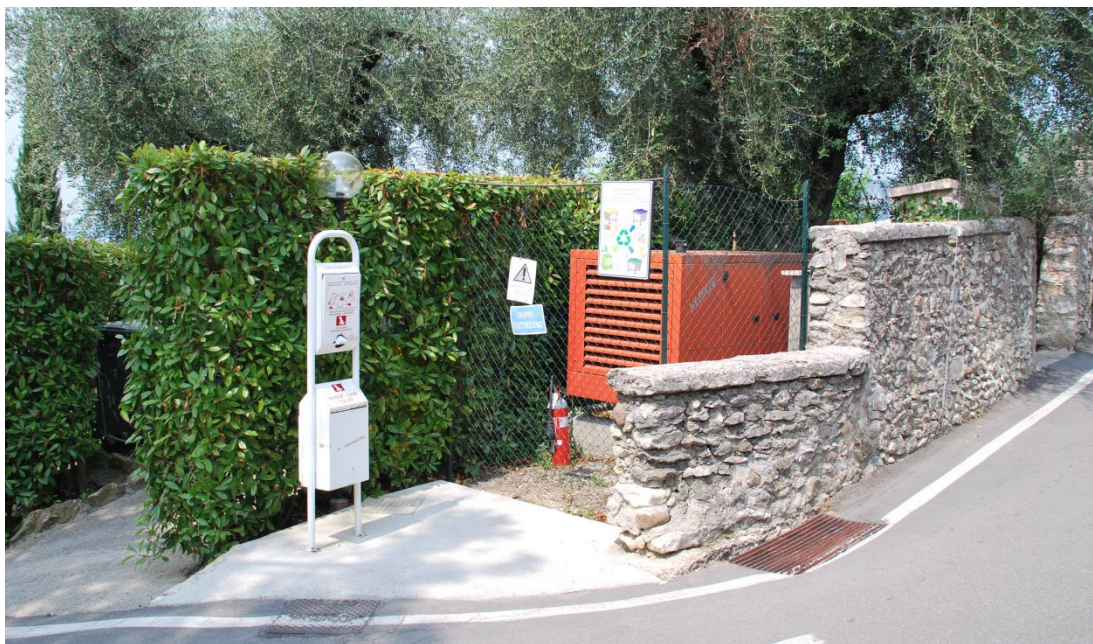
Figura 2.27 - Locale/area tecnologica: gruppo elettrogeno
